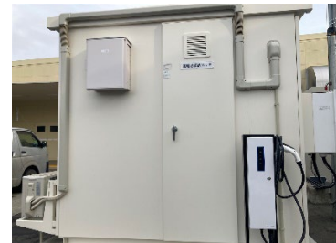
定置用蓄電池
